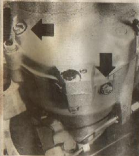
Fig. 25 Orificios de llenado y vaciado del aceite.
